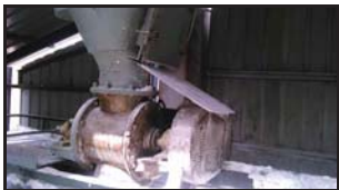
Existing dust silo : V-1702-1
